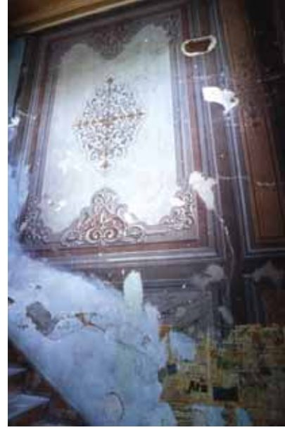
Şekil 24. Merdiven Boşluğu Kuzey Duvarı, Duvar Resmi
